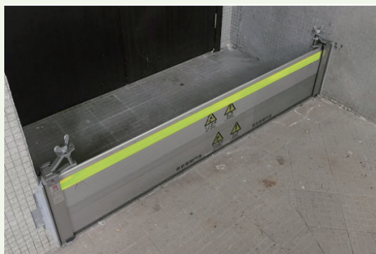
富豪機場酒店的防洪閘
